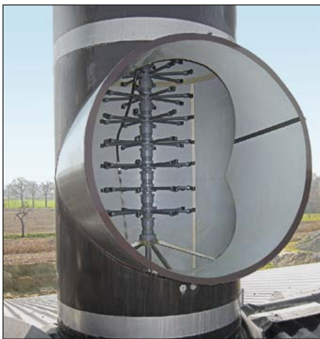
Vue sur le bouquet de buses par la grande ouverture de service
